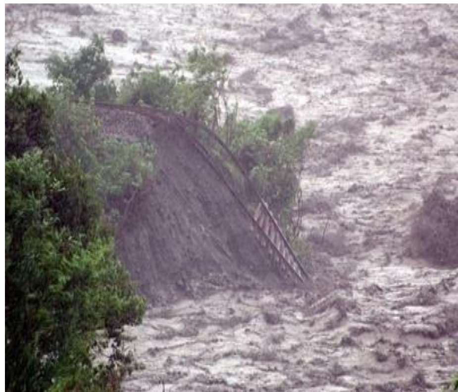
台東縣太麻里溪潰堤， 南迴鐵路流失近1公里 ，橋墩和基座成汪洋。
